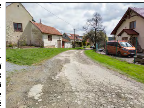
Místní komunikace vedoucí od domu č. 13 k domu č. p. 114 čekající na opravu.
